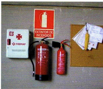
Foto 3: Disposición de equipos de seguridad y auxilio para los trabajadores.
